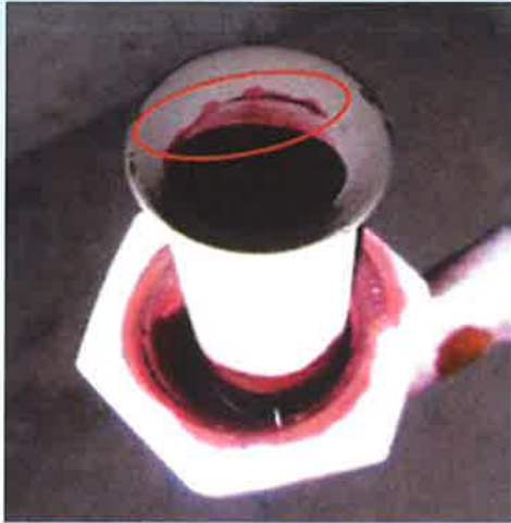
配管継手(フレア式継手)の亀裂発生箇所
